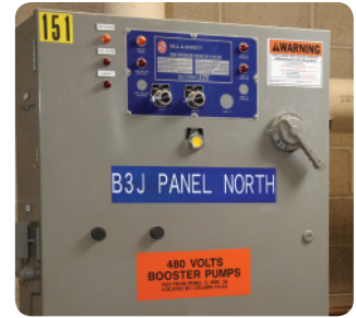
Kontrol Panosu ve Elektrik Panosu Etiketleri
