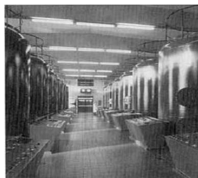
Oczyszczanie wody pitnej węglem aktywowanym (Zdj. Zakładu Lurgi, Frankfurt nad Menem)
