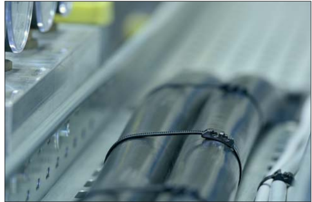
ROBUSTO Kabelbinder eignen sich für Kabeltrassen.
